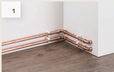
1 Heizungsrohre wirken unschön und störend
